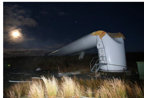
圖1-2 北愛爾蘭2.5MW之風力發電塔架折斷
